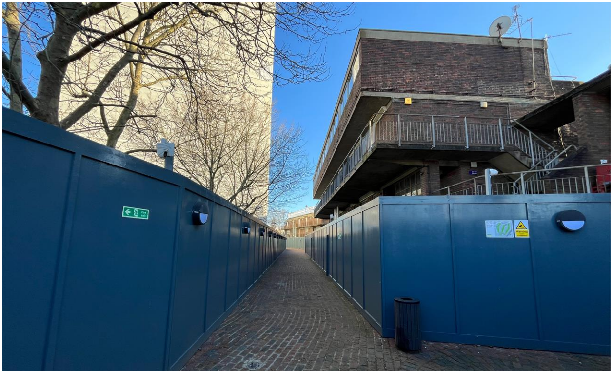
Fotografía del emplazamiento 11: Tramo occidental del paso elevado de Grenfell Walk y vallas (18/01/24)
